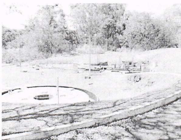
FIGURA 64 – VISÃO GERAL DO SISTEMA DE TRATAMENTO
