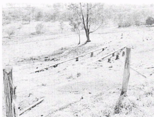
FIGURA 34 – ADUTORA DE ÁGUA BRUTA - ANTES DE CHEGAR NA EEB 03
