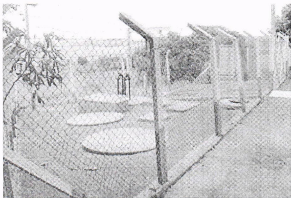
FIGURA 61 – VISTA DA ESTAÇÃO ELEVATÓRIA DE ESGOTO EEE07
