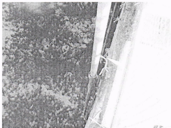
FIGURA 19 – CAPTAÇÃO DE ÁGUA BRUTA NO MANANCIAL
