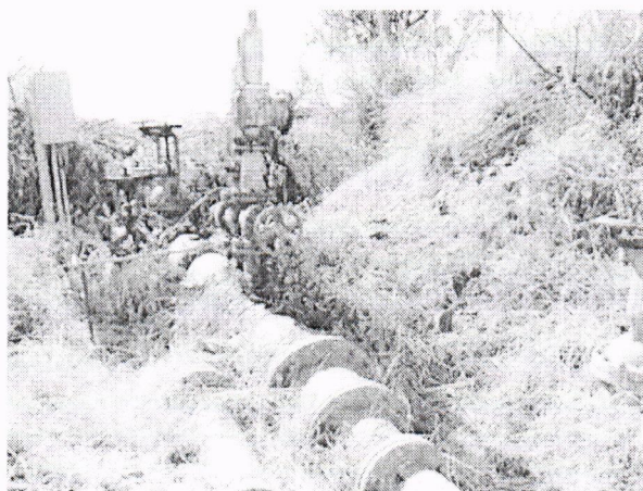
FIGURA 36 – ADUTORA DE ÁGUA BRUTA – SAÍDA DA EEB 03
