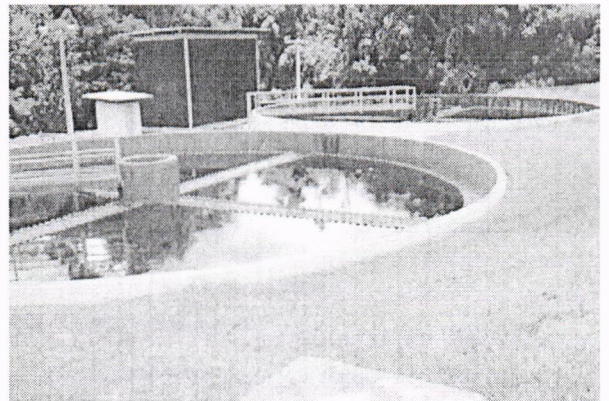
FIGURA 86 – VISTA DOS FILTROS BIOLÓGICOS
