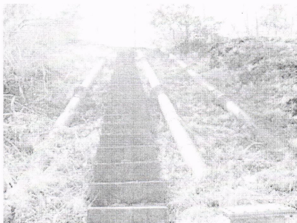
FIGURA 35 – ADUTORA DE ÁGUA BRUTA – SAÍDA DA EEB 03
